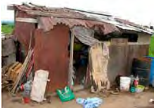
Antes. Unidad básica de vivienda rural de la localidad de Hueyapan, Municipio de Tetela del Volcán.
