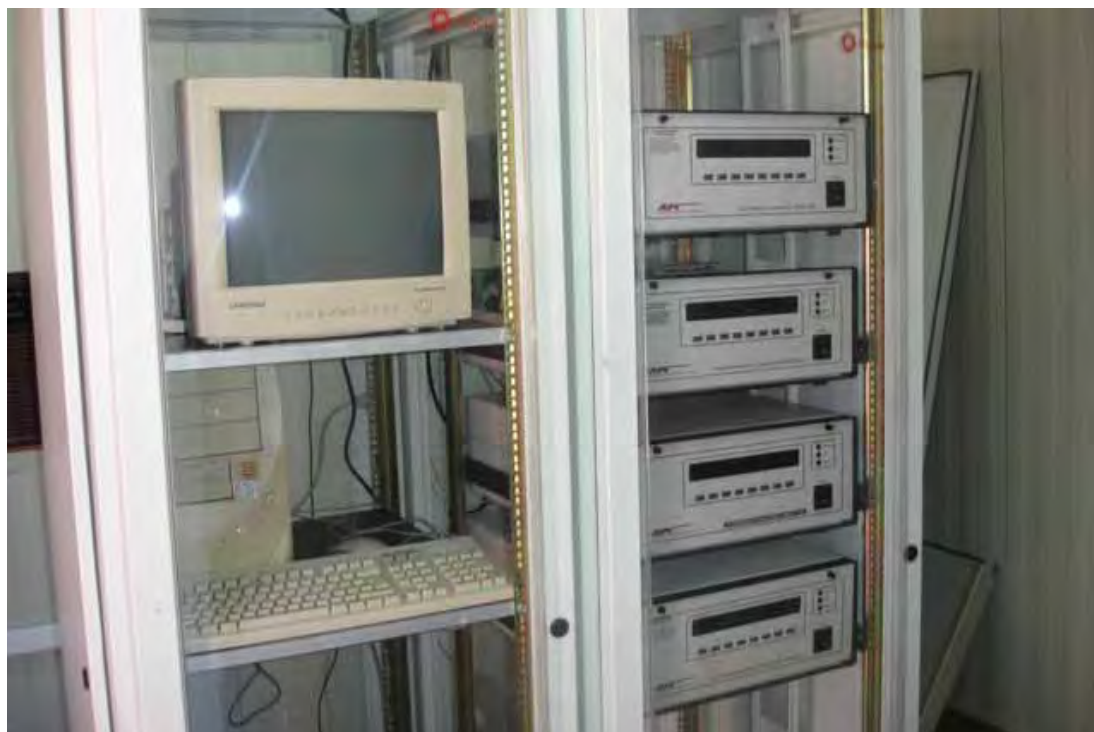
Equipo de monitoreo atmosférico.
